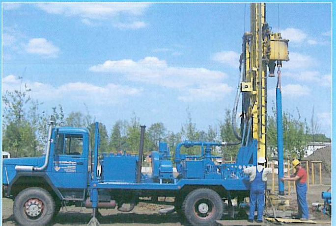
Immer bestens ausgerüstet: Heute werden tiefe Bohrungen bei Stükerjürgen mit Universalbohranlagen nach dem neuesten Stand der Technik ausgeführt.
